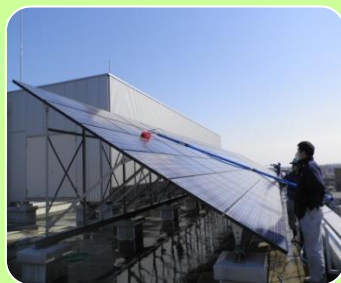
太陽光パネルの洗浄
