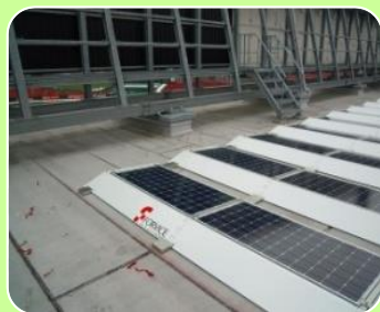
太陽光パネルの架台
