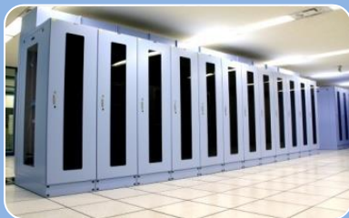
データセンター向け製品
