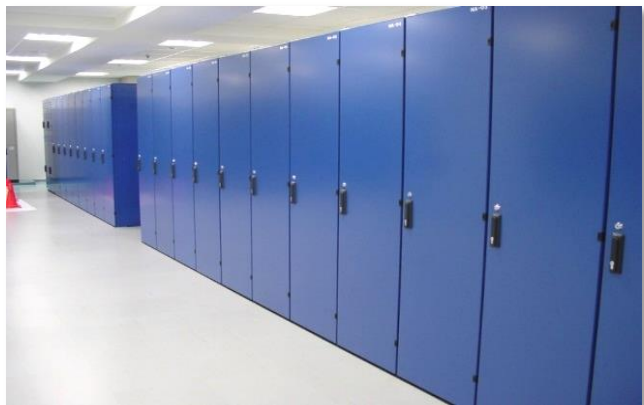
サーバーラック
